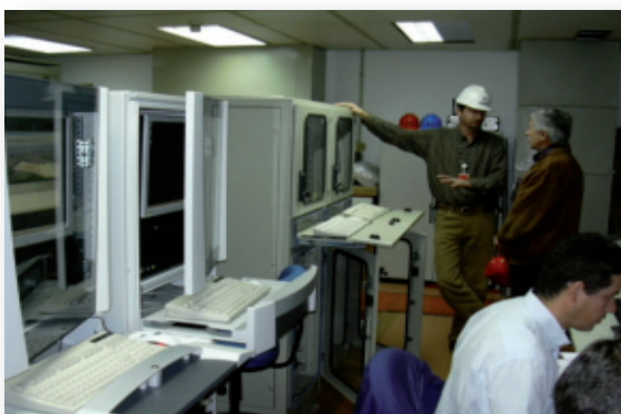
Sala de controle da barragem de ITAIPU
