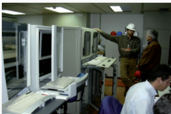
Sala de controle da barragem de ITAIPU
