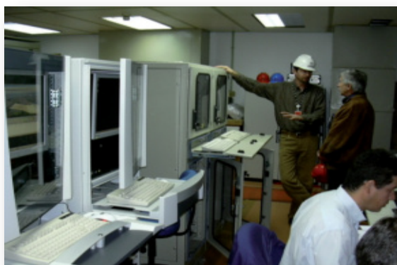
Sala de controle da barragem de ITAIPU
