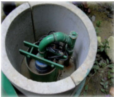
Controle de nível em poços, Baía de San Salvador, Brasil
