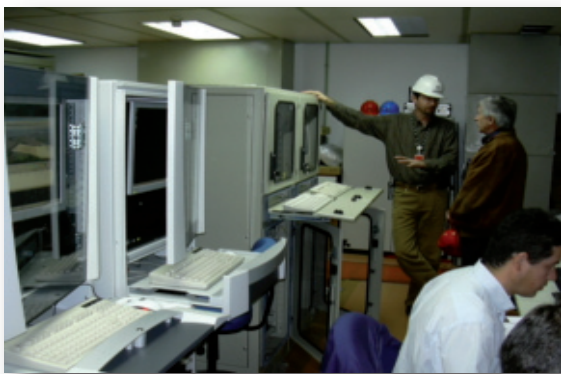
Sala de controle da barragem de ITAIPU
