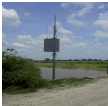
Controle de nível no rio Salado, província de Santa Fe, Argentina.
