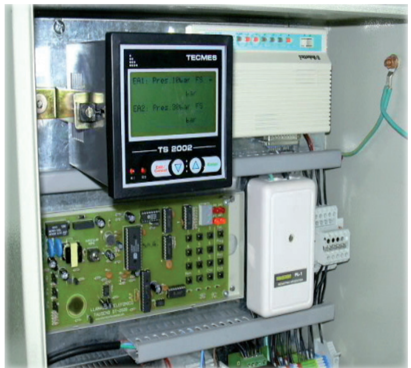
Controle de pressão em gasodutos, Gas NEA, Entre Ríos, Argentina
