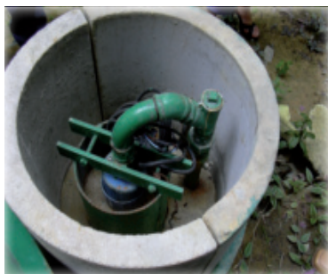
Control de niveles en pozos, Bahía de San Salvador, Brasil
